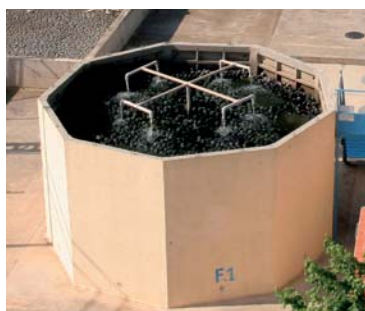
Filtro percolador de la EDAR de Tirig.
