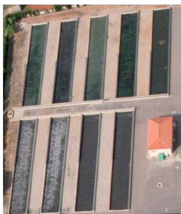
Lechos de turba de la EDAR de Benlloch.
